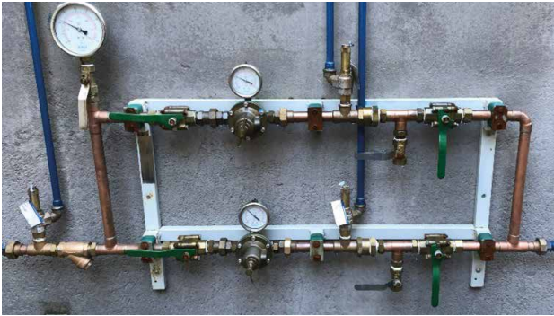
Rede de óxido nitroso desativada em março/2024
