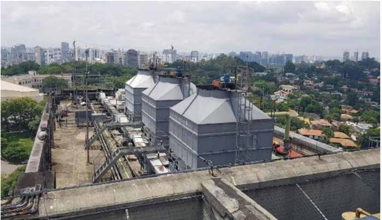
Central de Água Gelada (CAG) no Complexo Hospitalar – Unidade Morumbi. Antes do projeto
